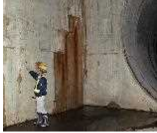
漏水・錆汁（美園立坑）
