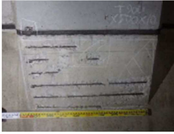
鉄筋露出（長瀬調節池）
