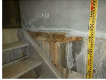
剥離（大正川調節池）
