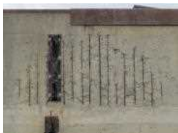
剥離・鋼材露出
