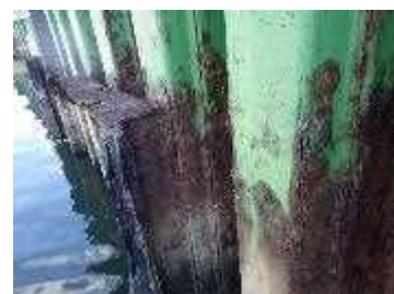
塗装の剥がれ・錆
