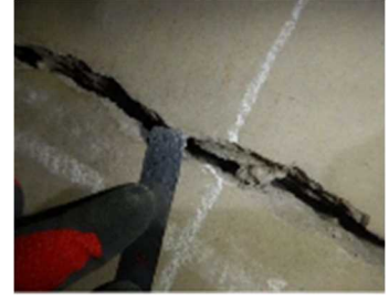
ひび割れ（今川立杭）
