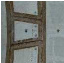
上記（鋼材の発錆）の 拡大写真
