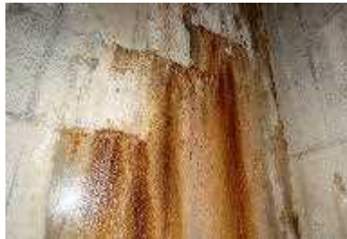
上記（漏水・錆汁）の 拡大写真
