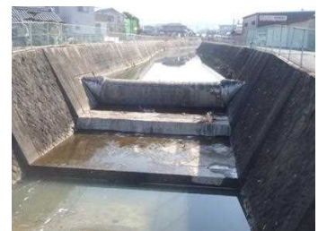
(ゴム引布製起伏堰(参考))
