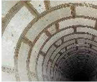
鋼材の発錆（久宝寺調節池）
