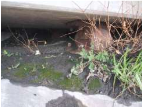
《支承まわりの土砂堆積の様子》
