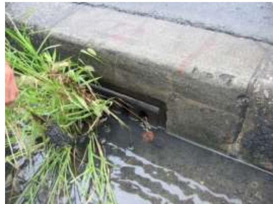
写真 2.1-3 排水口の詰り
