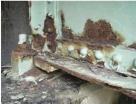
《下フランジ上面の腐食》
