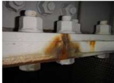
添接部の局所的な腐食
