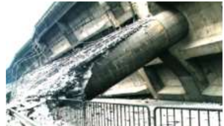
写真 3.1-5 阪神淡路大震災での橋梁倒壊事例
