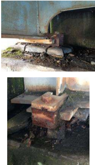
支承の損傷状況
