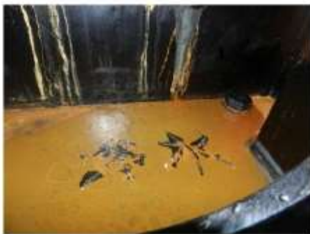
箱内部の滞水
