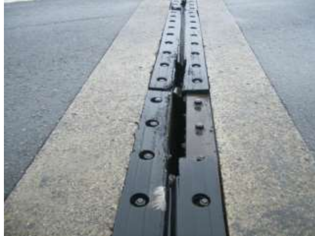
《損傷ジョイントの様子》
