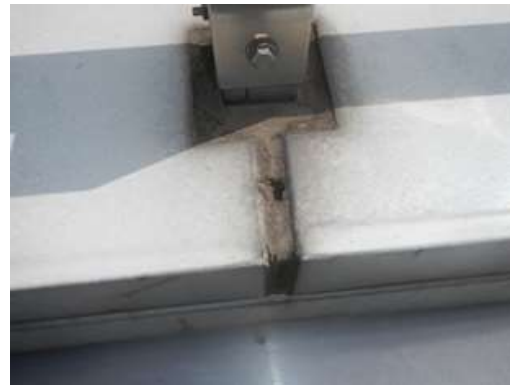
シール材の劣化
