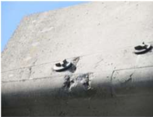
剥離・鉄筋露出
