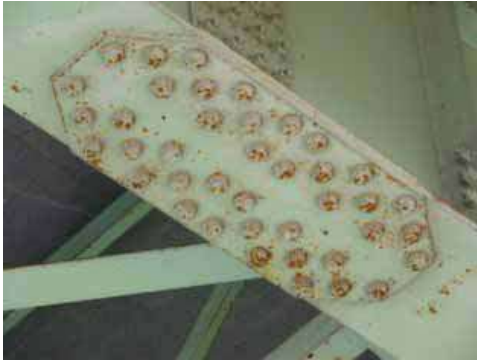
《添接部の腐食》
