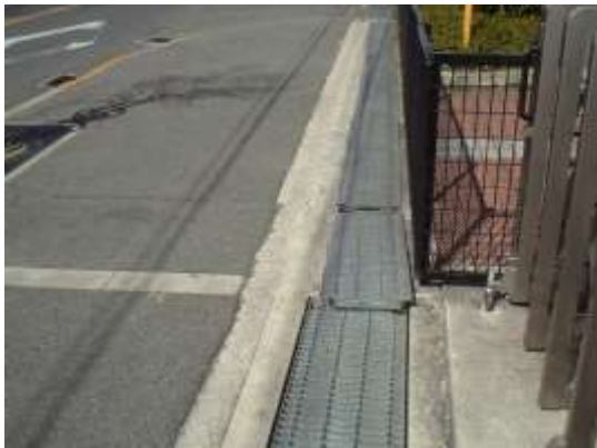
写真 2.1-2 側溝の蓋のはずれ
