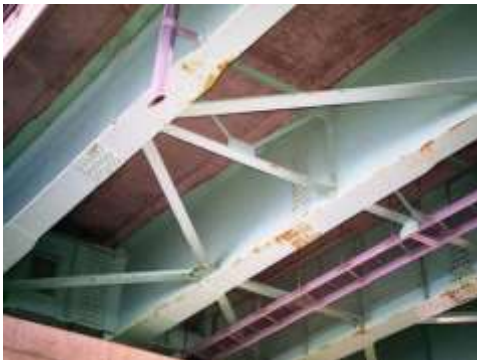
《下フランジ下面の腐食》
