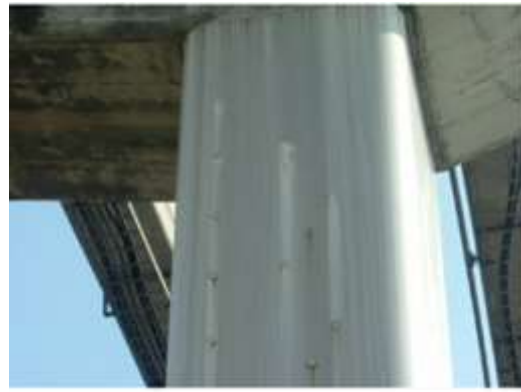
耐震補強材の劣化
