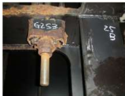
支承アンカーボルト受けの腐食
