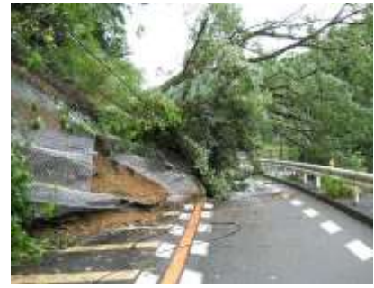
写真 3.1-3 法面崩壊状況
