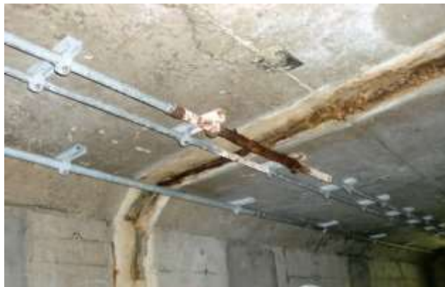
写真 2.1-1 最も古い共同溝と継ぎ目からの漏水と付帯管路の腐食状況
