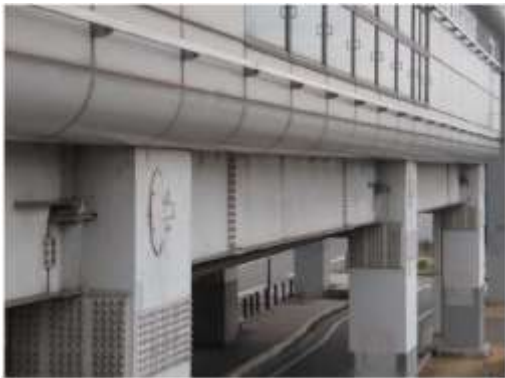
外壁の塗膜の劣化
