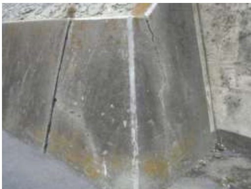
擁壁クラック
