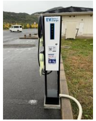
いきいきパークみさき (普通充電 4基)
