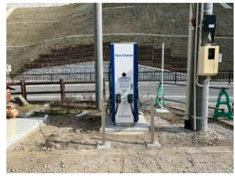
槇尾こもれびの森 (急速充電 1基)
