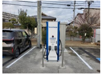
富田林保健所 (急速充電 1基)
