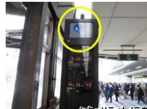
セキュリティカメラの設置
