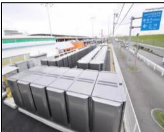
○中央卸売市場の燃料電池
