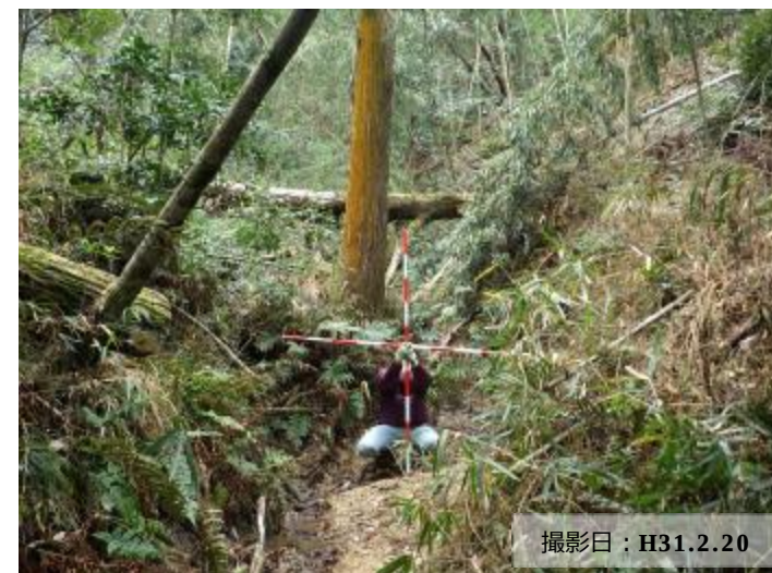
写真① 施工前（倒木等の状況）
