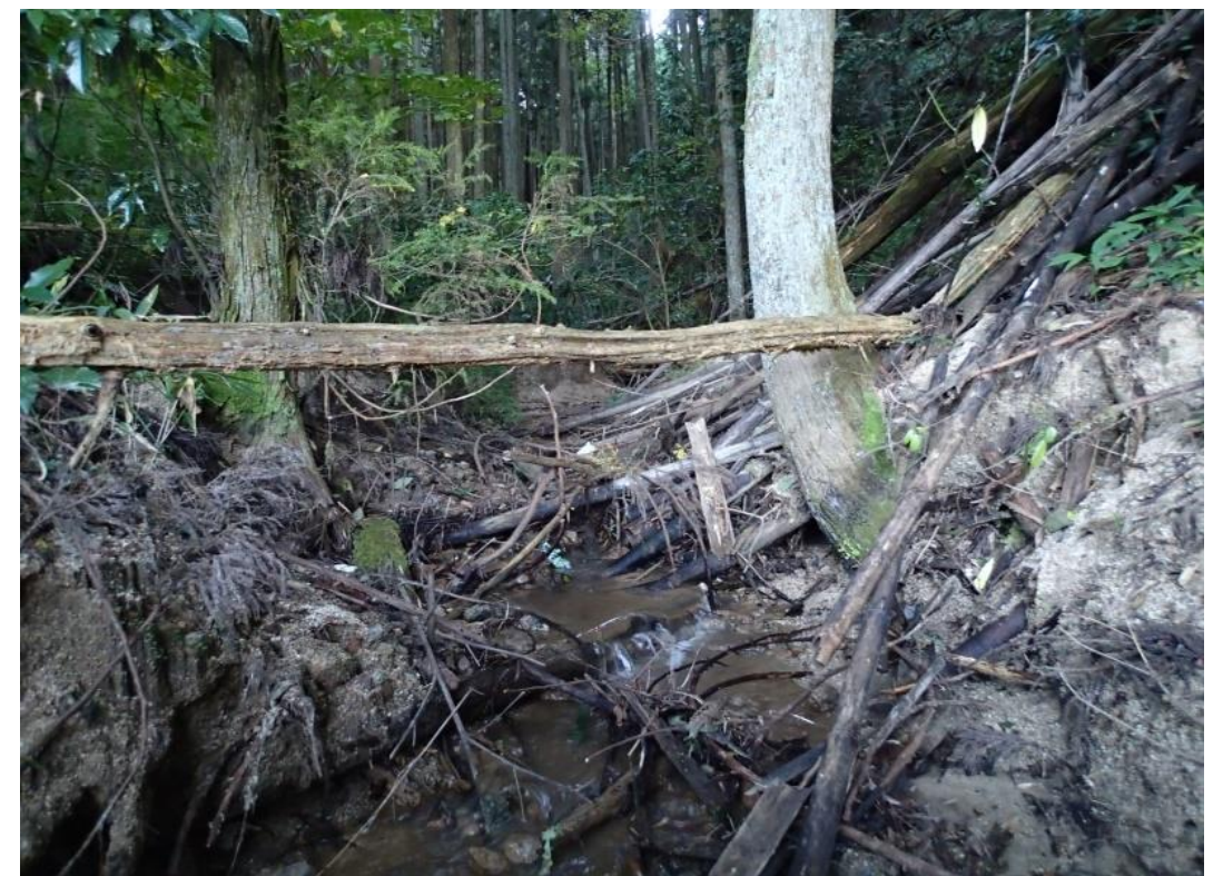
溪流流末部の溪岸浸食と土砂堆積状況
