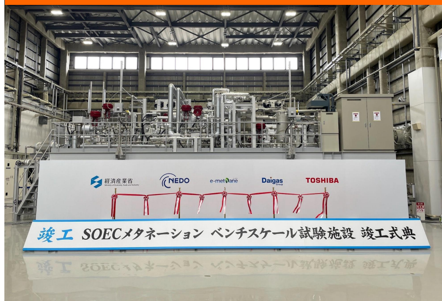
SOEC水蒸気電解装置
