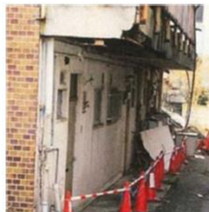
外壁剥落等の危険な状態
