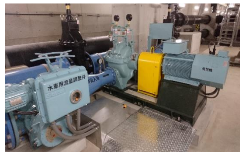
咲洲水力発電設備
