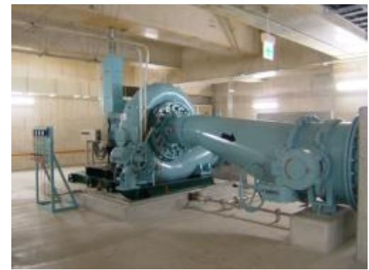
長居水力発電設備
