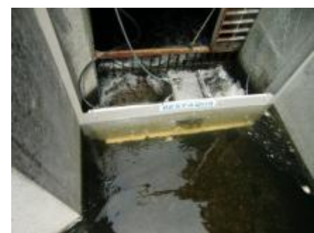
南部水みらいセンター（泉南市）
