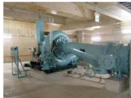
長居水力発電設備
