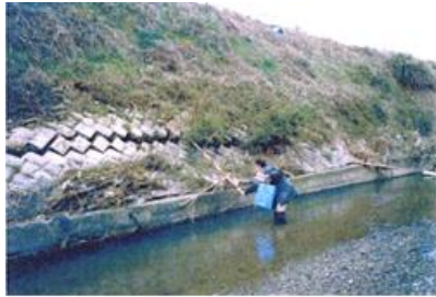
損傷状況（対策前）
