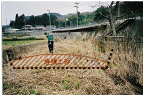
土砂堆積状況（対策前）
