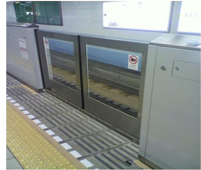
可動式ホーム柵の設置事例（大阪市内）
