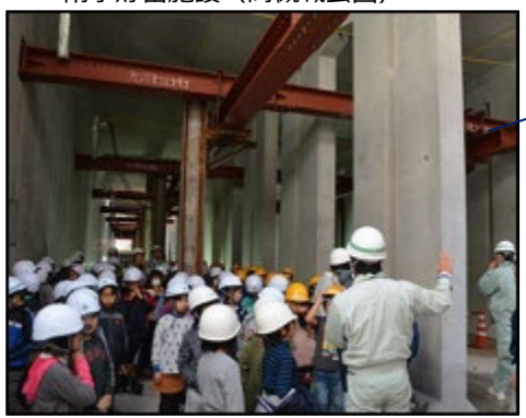
雨水貯留施設(高槻城公園)
