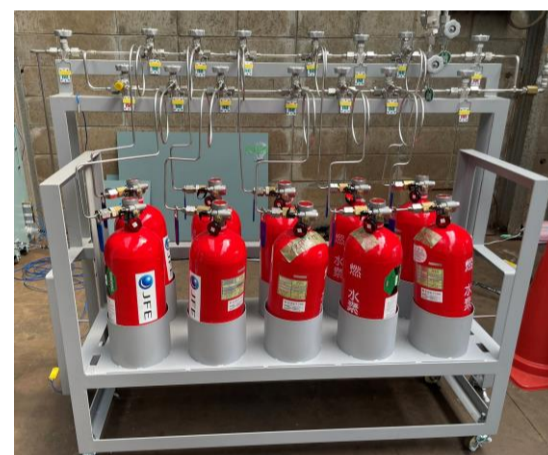
水素充填架台
