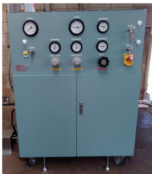
水素圧縮装置
