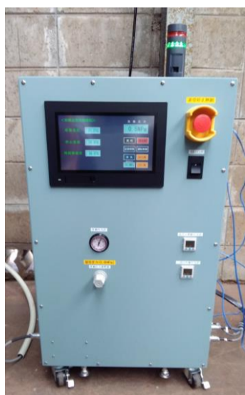
制御システム
