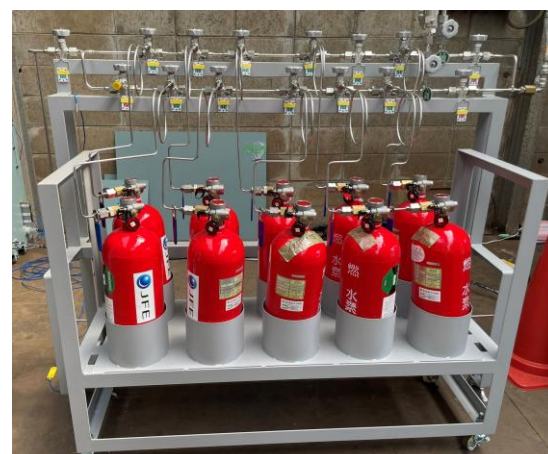
水素充填架台
