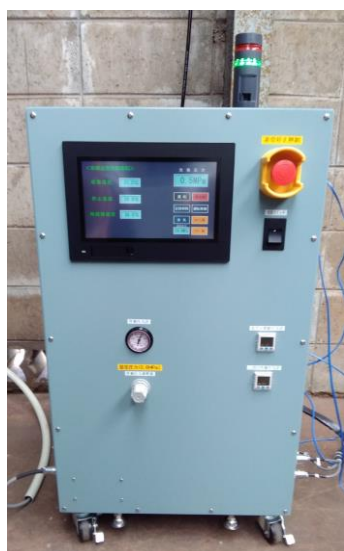
制御システム
