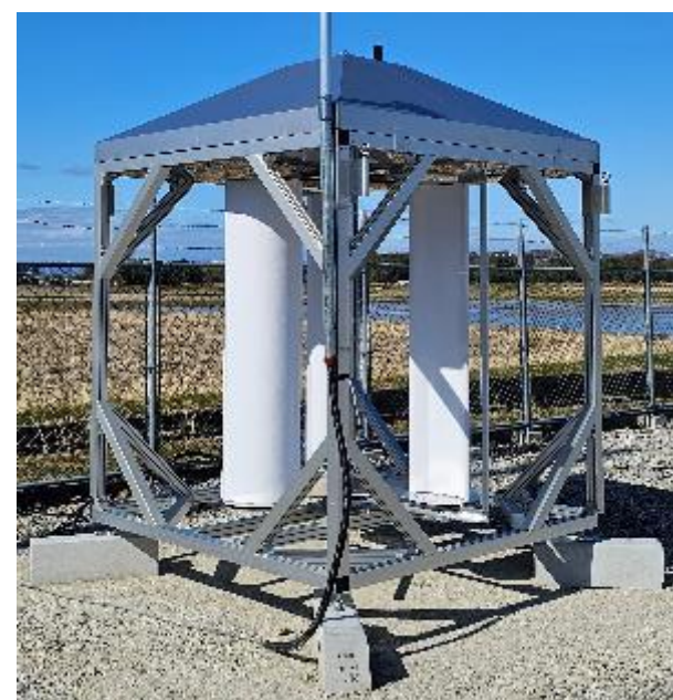
実証実験中の 勾玉形風力発電設備
