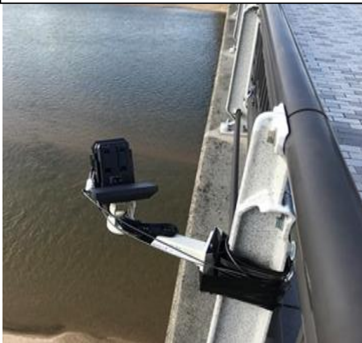
カメラの設置状況（木津川）
