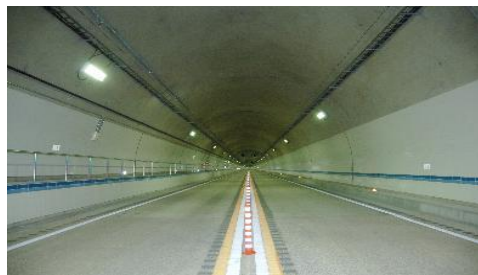
現在のトンネル照明
