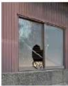
窓が割れた管理不全空家
