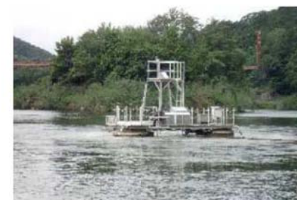
写真 4.2-2 浅層曝気循環設備 (室生ダム) (出典：ダム等管理フォローアップ定期報告書)
