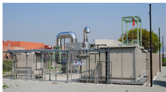
消化ガス発電設備
