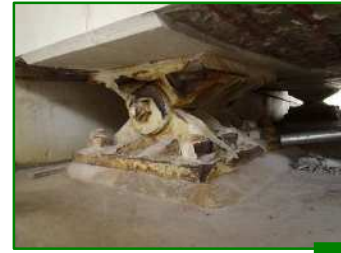
支承再塗装(補修前)
