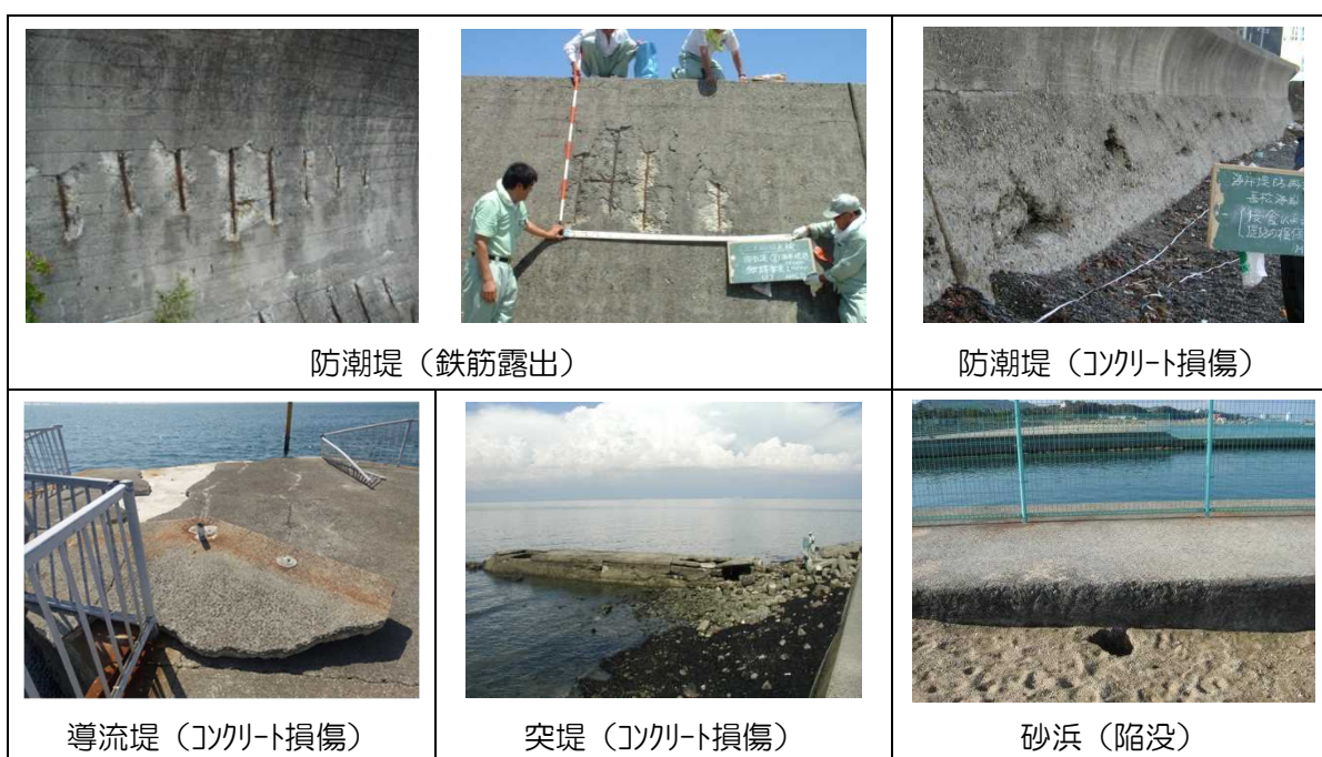
図 3.1-9 主な海岸施設の劣化状況
