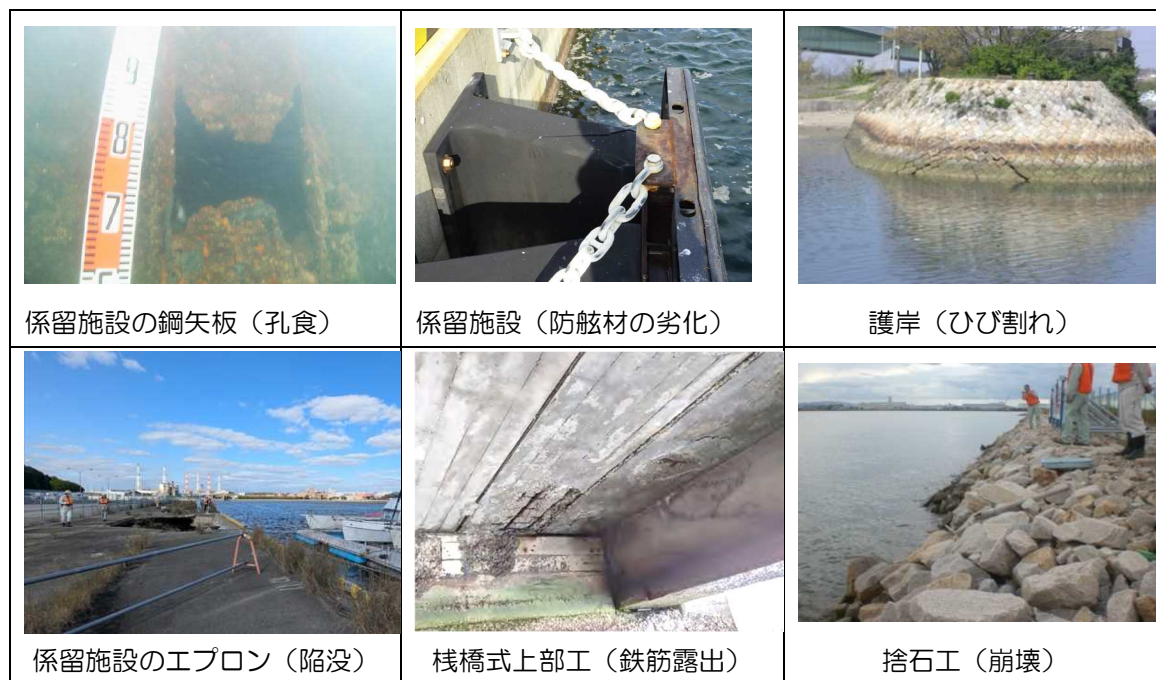
図 3.1-5 主な港湾施設の劣化状況
