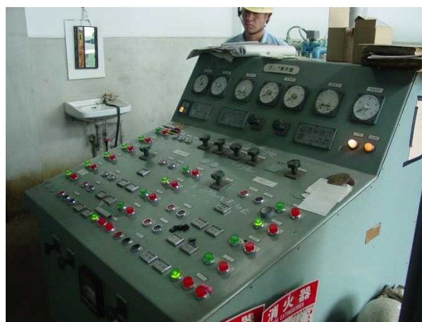
電気設備の陳腐化
