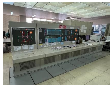
監視制御設備
