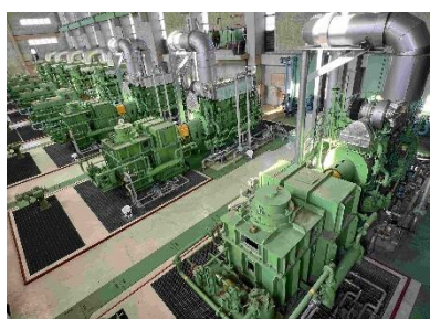
雨水ポンプ設備
