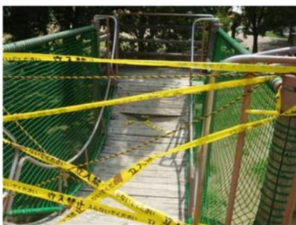
劣化による破損（利用停止）
