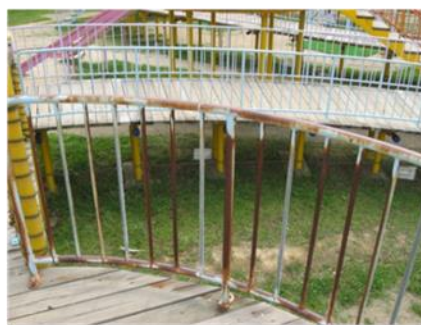
劣化による腐食
