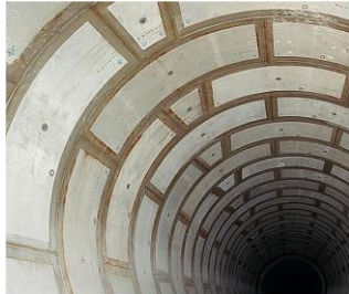
鋼材の発錆（久宝寺調節池）
