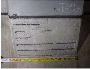
鉄筋露出（長瀬調節池）
