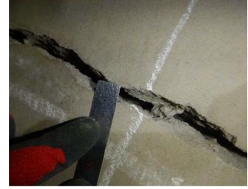
ひび割れ（今川立杭）
