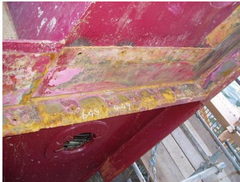
水門扉体の腐食状況
