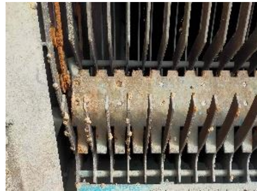
除塵機の腐食状況
