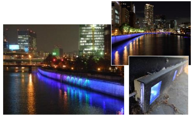
護岸照明施設（大川、堂島川）
