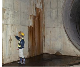
漏水・錆汁（美園立坑）
