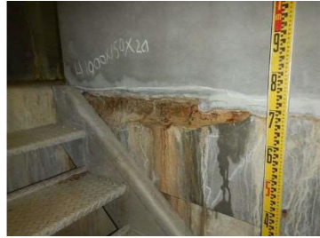
剥離（大正川調節池）
