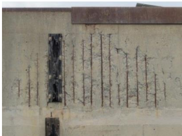
剥離・鋼材露出
