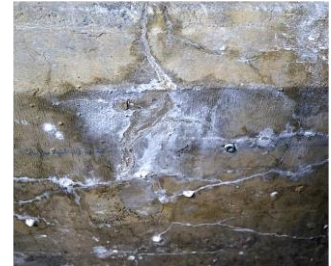
ASR（今川立坑）
