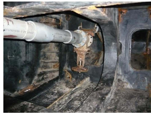
水門扉体内面の腐食状況
