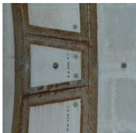
上記（鋼材の発錆）の 拡大写真
