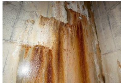
上記（漏水・錆汁）の 拡大写真
