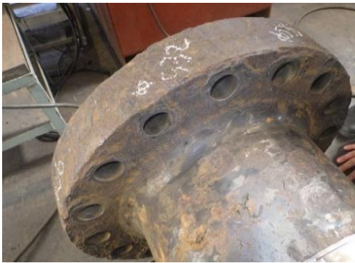
ポンプ軸の腐食状況
