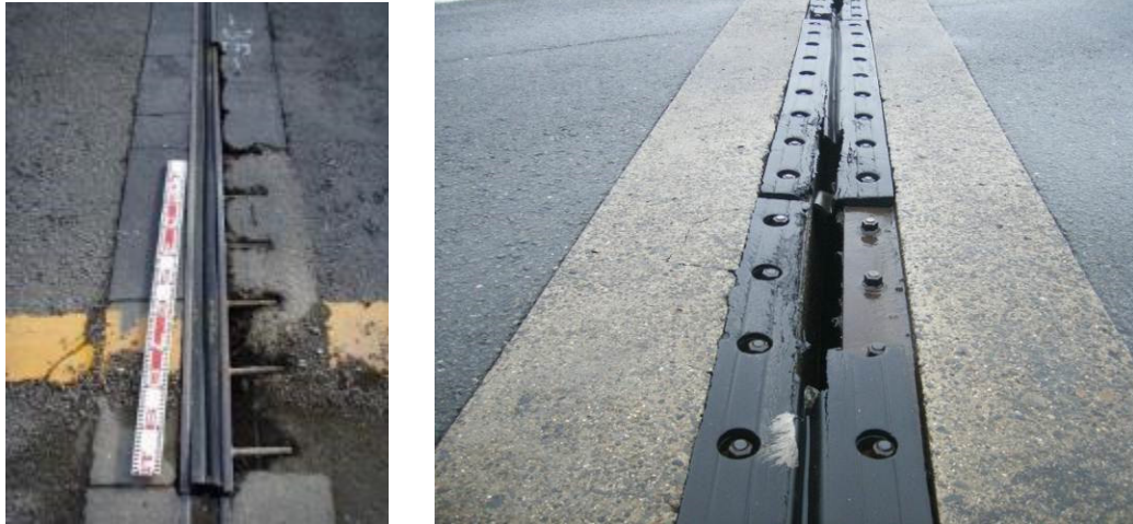
図 3.1-20 損傷ジョイントの様子
