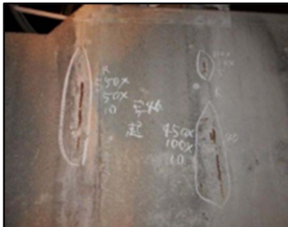
剥離・鉄筋露出
