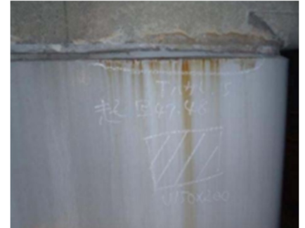
補強材の腐食
