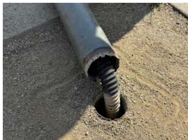
腐食により破損した箇所（支柱の根本）
