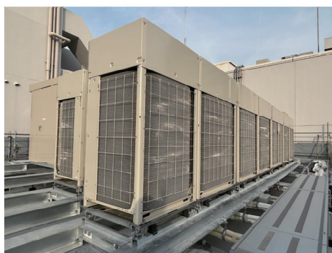
高効率空調機(室外機)
