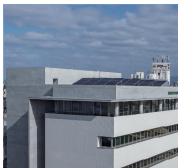
太陽光発電設備
