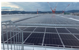
太陽光発電設備
