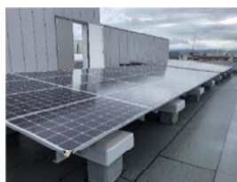
太陽光発電設備
