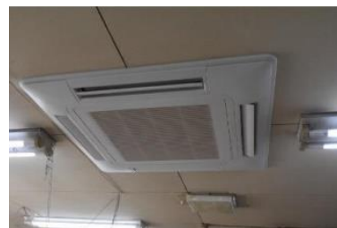
高効率空調機の例
