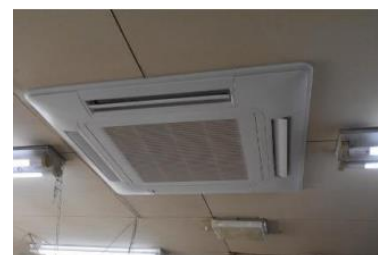
高効率空調機の例
