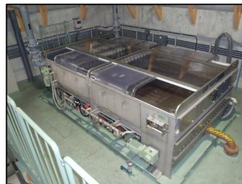
省エネ機器の導入 (渚水みらいセンター)
