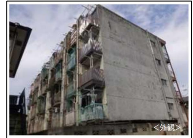
建物の傷みが著しく外壁の剥落、鉄骨の露出などが見られる事例（出典：国土交通省）
