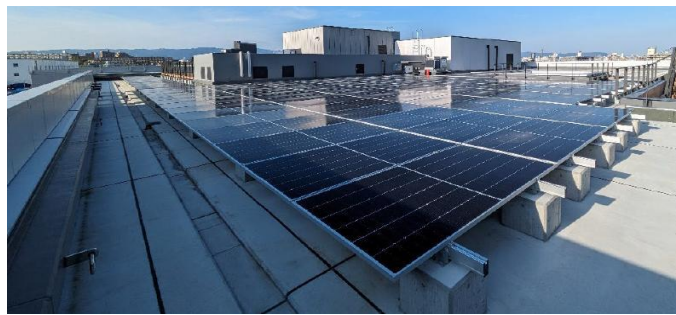
太陽光パネル
