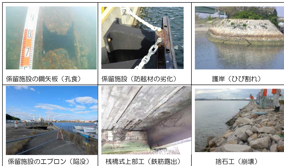
図 3.1-5 主な港湾施設の劣化状況
