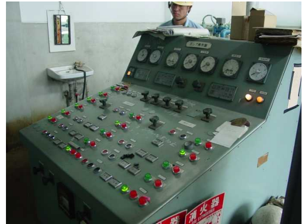
電気設備の陳腐化
