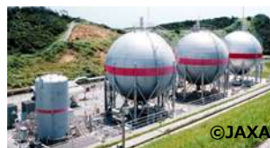
液化水素タンク
