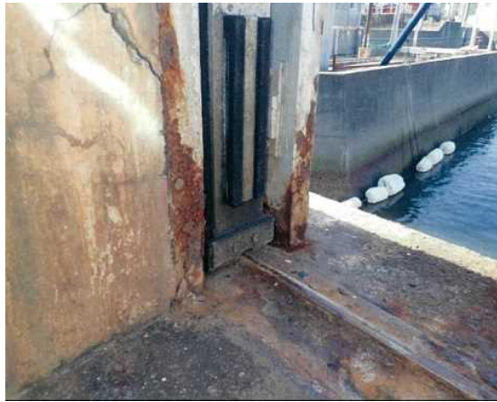
防潮扉の腐食
