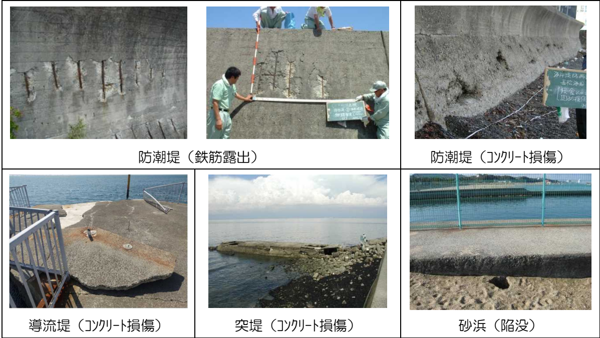
図 3.1-9 主な海岸施設の劣化状況
