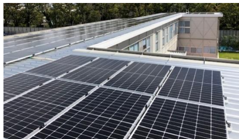
事務所の屋根を利用した太陽光パネル設置
