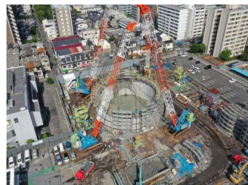
立坑築造に係る工事電力の全てをRE100使用 (立坑掘削状況 全景)
