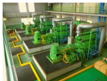
雨水ポンプ設備
