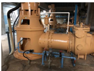
汚水ポンプ設備
