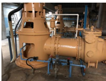
汚水ポンプ設備
