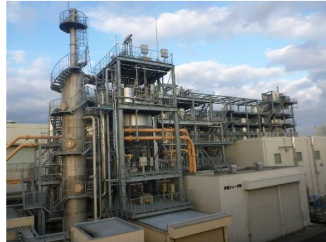
次世代型汚泥焼却炉
