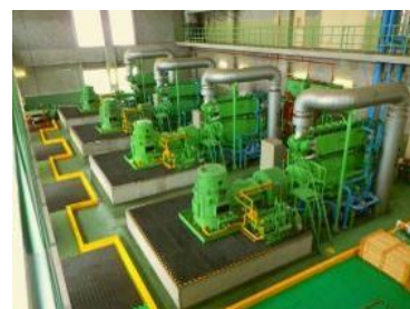
雨水ポンプ設備
