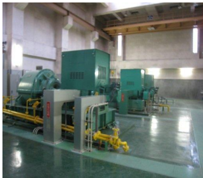
【水みらいセンター 棟内の照明】
