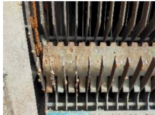
除塵機の腐食状況
