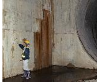
漏水・錆汁（美園立坑）
