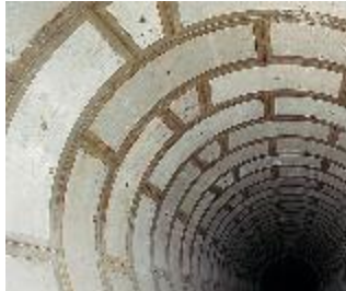
鋼材の発錆（久宝寺調節池）
