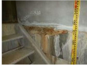
剥離（大正川調節池）
