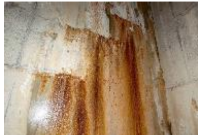
上記（漏水・錆汁）の 拡大写真
