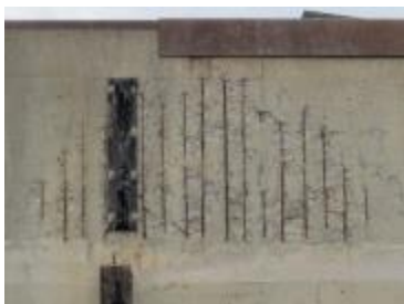
剥離・鋼材露出
