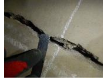
ひび割れ（今川立杭）
