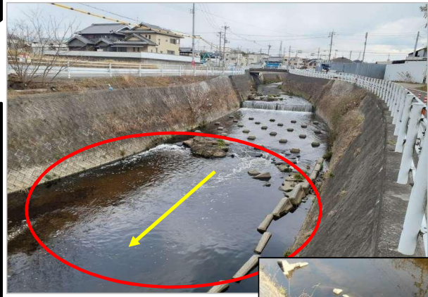
東除川 R3-1 河床の洗堀 3
