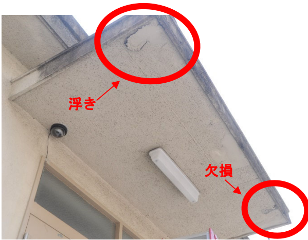
【事例 11】出入口上部の庇のモルタルの浮き（手前）とコンクリートの破損（奥） （写真提供：（一財）日本建築防災協会）
