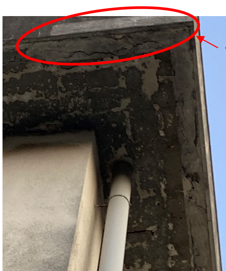
【事例 3】 軒天井のひび割れ
