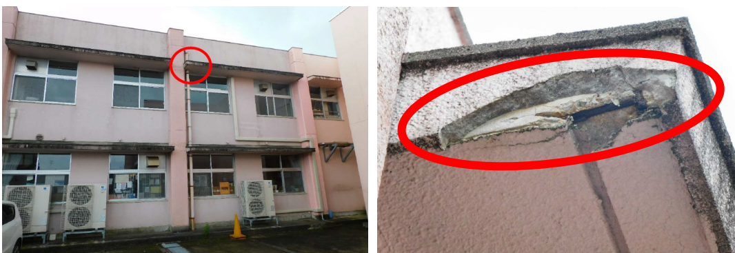
【事例 9】 校舎の 2 階庇のコンクリートの一部が落下。
