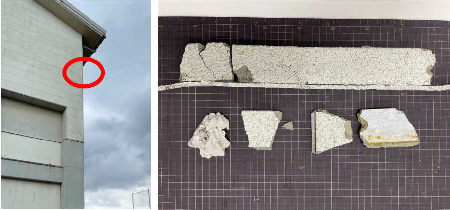
【事例 7】 体育館の外壁のモルタルの一部が落下。
